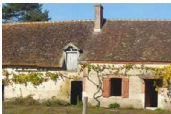
Les deux solutions sur la même façade : à gauche, dans la partie la plus ancienne (pan de bois masqué par un enduit ciment), débord de toit important et léger coyau, chevrons apparents coupés à 90°. À droite, corniche en briques sur l'extension réalisée au cours du 19 ème siècle.
