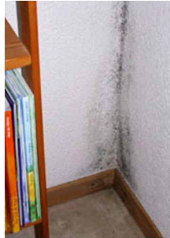
Apparition de moisissures due à une rupture d'isolant derrière le parement (source, internet)
