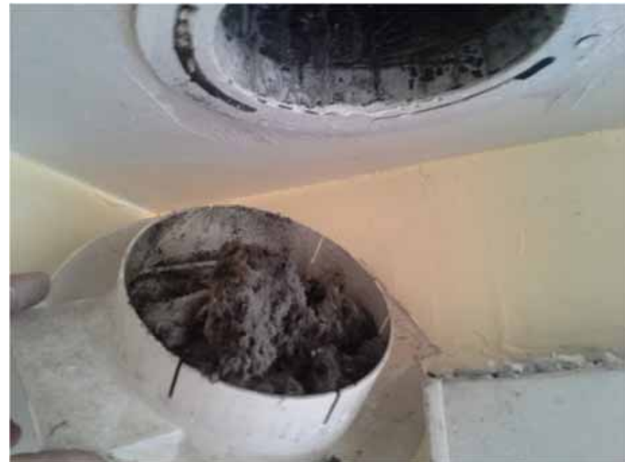
Défaut d'entretien d'une VMC... (source, internet)
