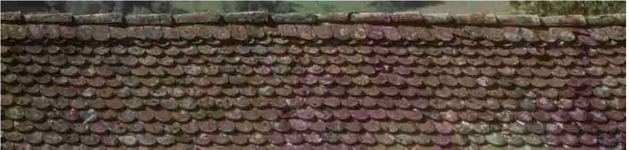
Saint-Pierre-de-Chartreuse (Isère), 1994. faîtage constituée de tuiles creuses à peine chevauchantes posées sur une double rangée de tuiles écailles.
